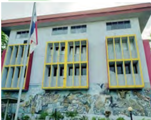
Mantenimiento de la Facultad
