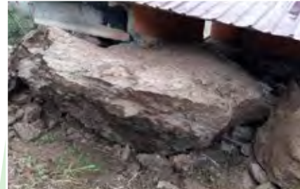
Inspección ante remoción de masas por desprendimiento de rocas
