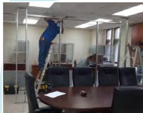
Remodelación del Salón de Profesores, por parte de la Dirección de Mantenimiento
